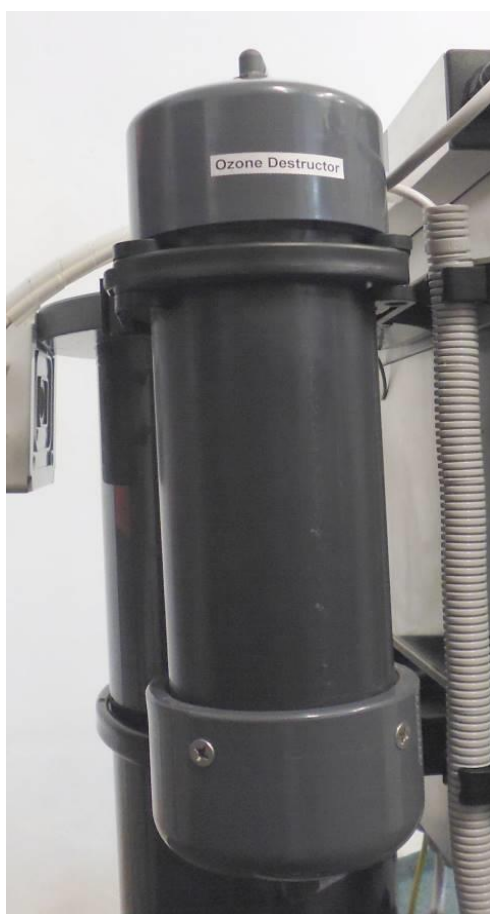
Obr.10 Destruktor zbytkového ozonu
